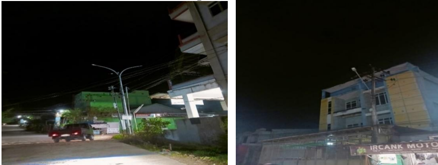
Gambar 1 Titik Lampu Penerangan Jalan Umum
